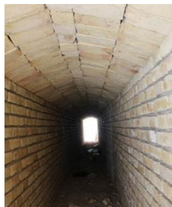
شکل ۱۳. داخل ناکش منبع: ۵. رضوی
