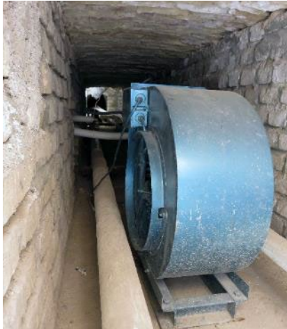
شکل ۴. خانه لاری‌ها، یزد، قراردادن بادزن (فن) در ناکش جهت تسریع در تبخیر رطوبت (Author, 2022)
