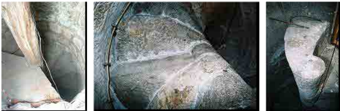
شکل ۴: نمونه اتصالات پلکانی برای مناره‌های بتایی مختلف در ترازون سمت راست: اتصال پلکان مسجد کودرتین به بالکن، وسط: اتصال پلکان مسجد فاتح به بالکن، سمت راست: پله مسجد کودرتین (Doğangün et al., 2006).
