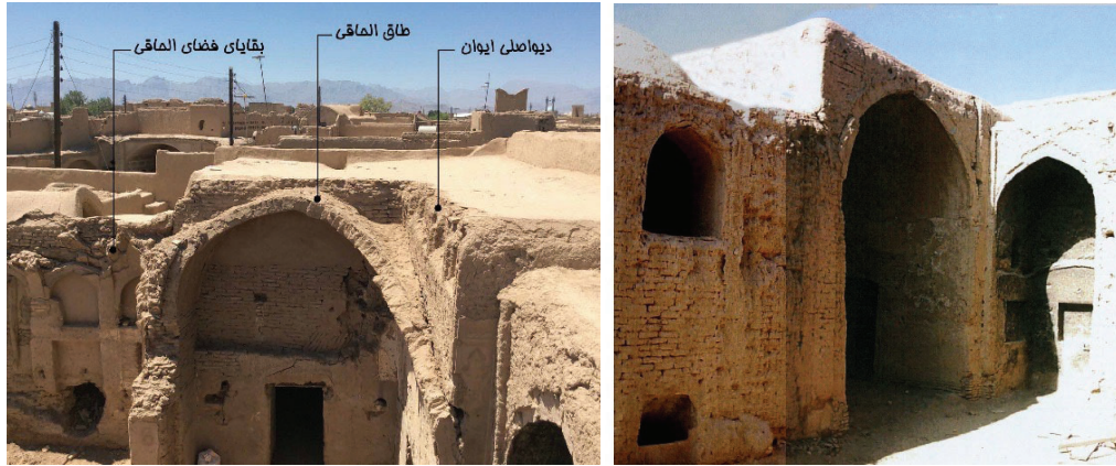
شکل ۱۸ و ۱۹. راست: ایوان پیش از خرابی (گرگویی، ۱۳۸۴)، چپ: بقایای تعمیرات انجام شده در ایوان و ضلع شرقی ایوان.
